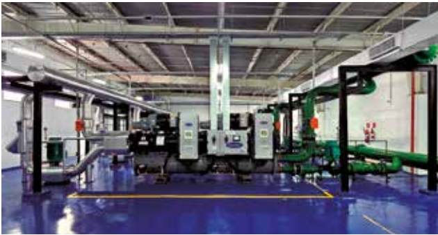
Central de água gelada
