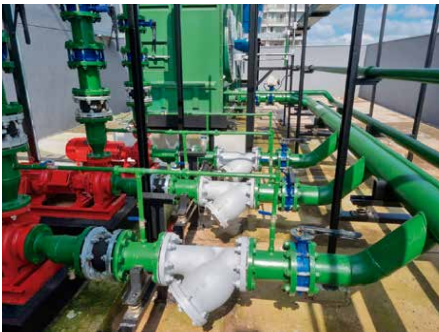
Central de bombeamento do condensado
