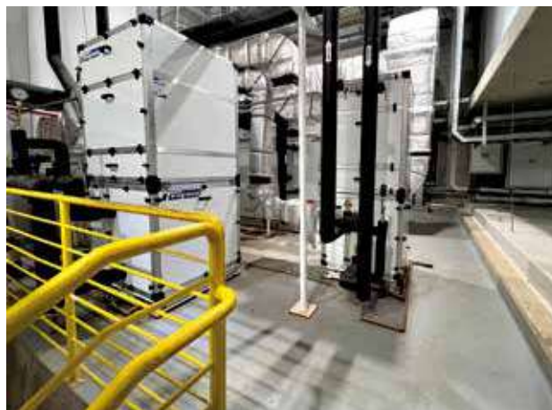
Tratamento de ar
