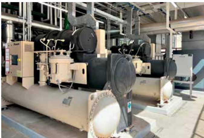
Central de água gelada
