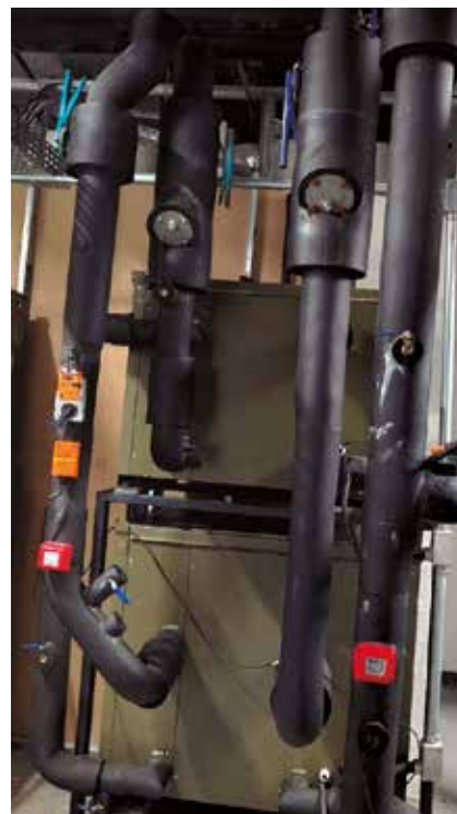
Bombas de calor água- água
