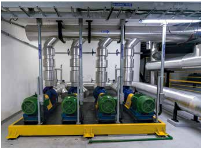
Central de água gelada
