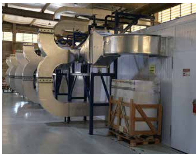
Exaustão da câmara de expansão do pentano
