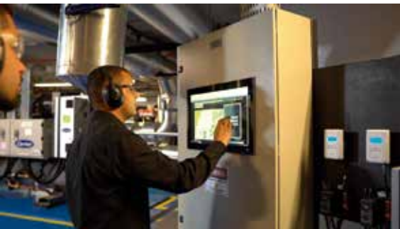
Painel de automação
