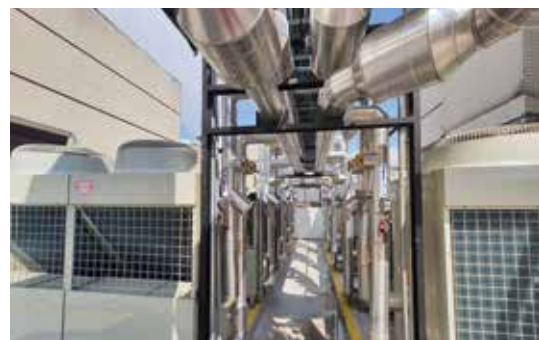
Central de água gelada e quente favorece a economia de energia
