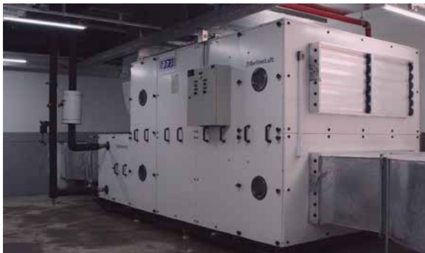
Unidades de tratamento de ar
