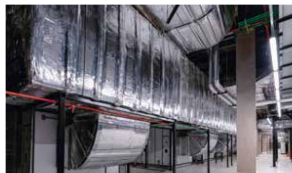
Unidades de tratamento de ar
